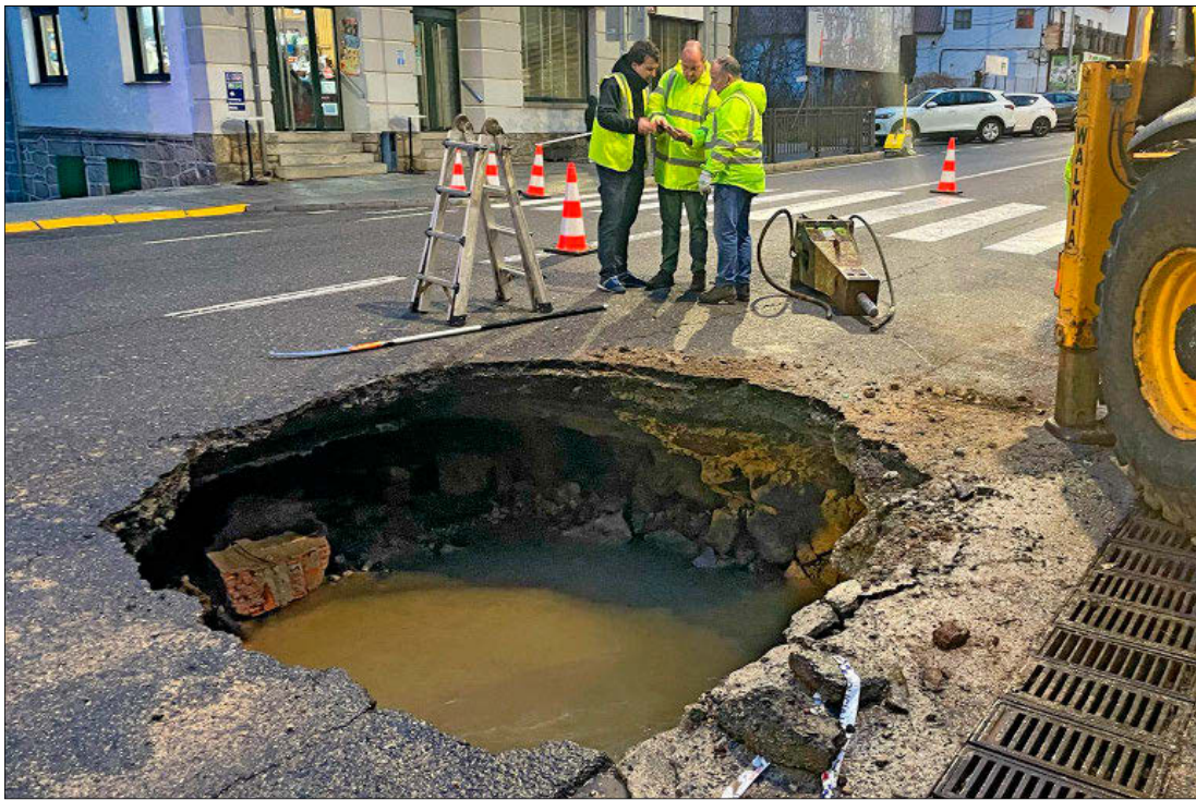
Socavón en la N-VI a su paso por El Espinar, provocado por el paso de un camión de gran tonelaje. E. M.
