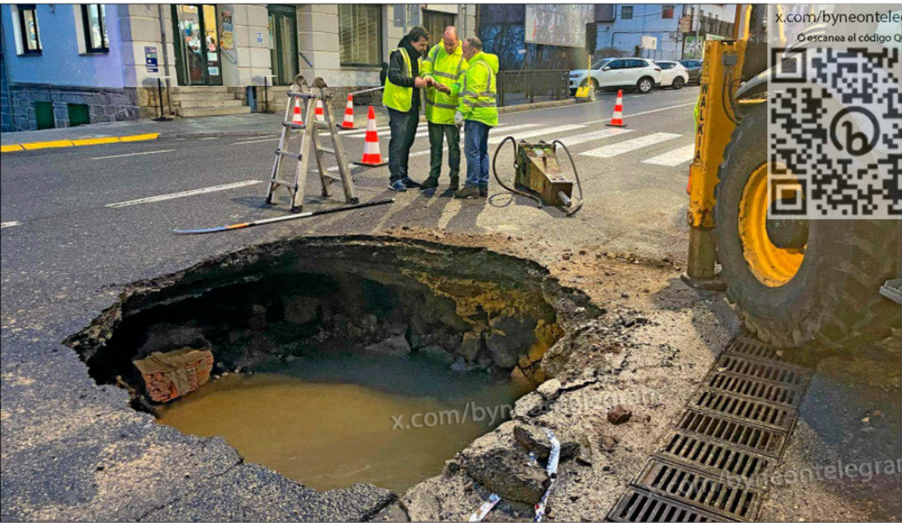
Socavón en la N-VI a su paso por El Espinar, provocado por el paso de un camión de gran tonelaje. E. M.
