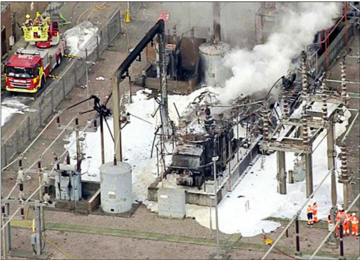
Bomberos trabajan, ayer, en el incendio de una subestación eléctrica. AP
