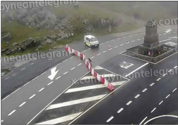
Corte del tráfico en el Alto del León, por el socavón. DGT
