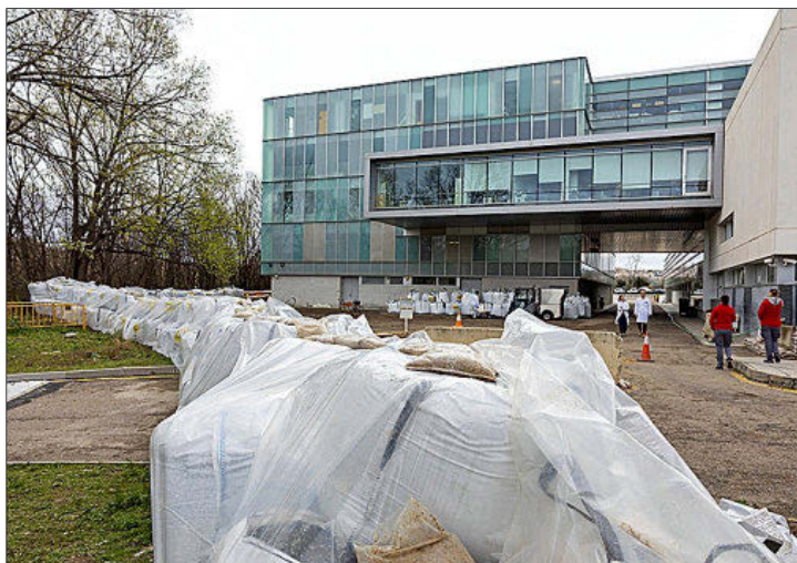
Dique en el Hospital Nacional de Paraplégicos (Toledo). Á. VISDÓMINE / EFE
